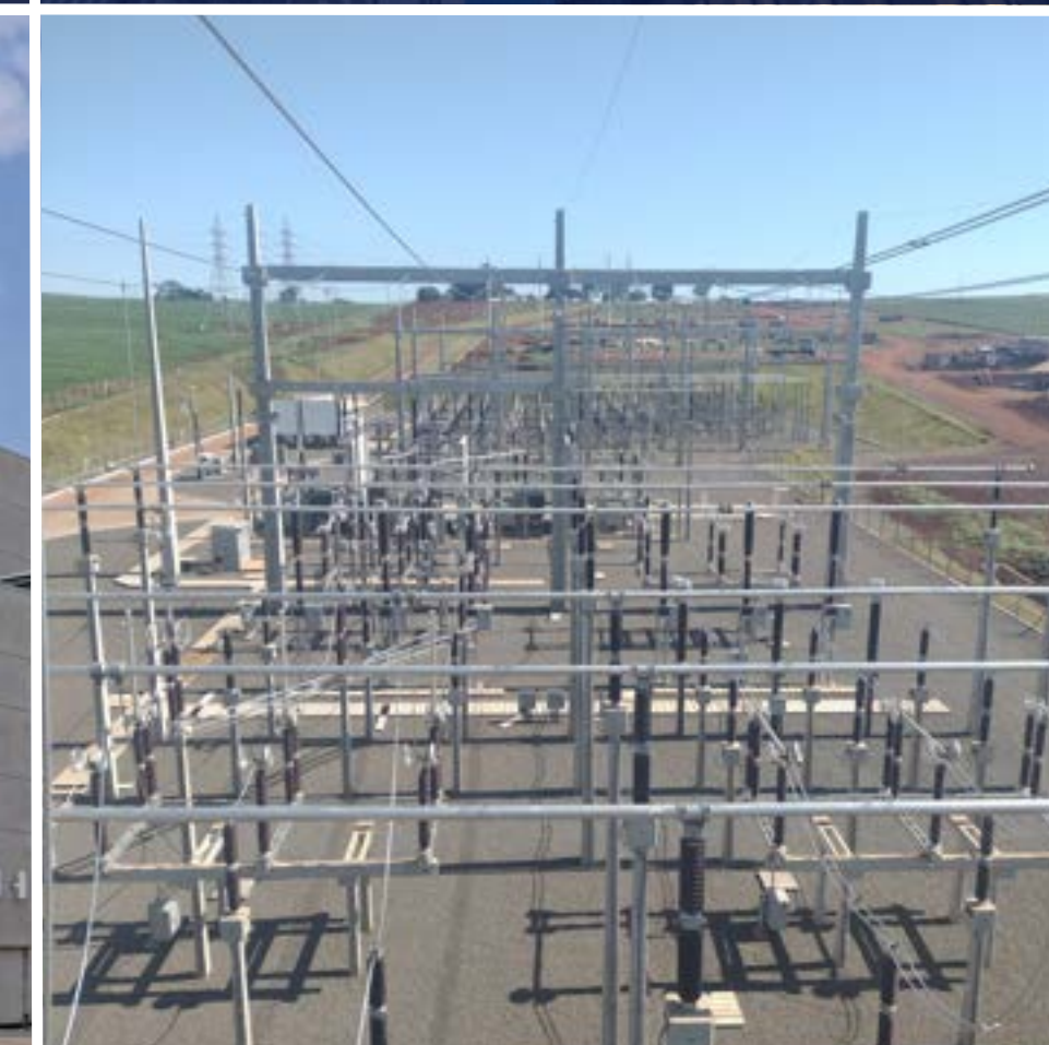
SUBESTAÇÕES DE ENERGIA
