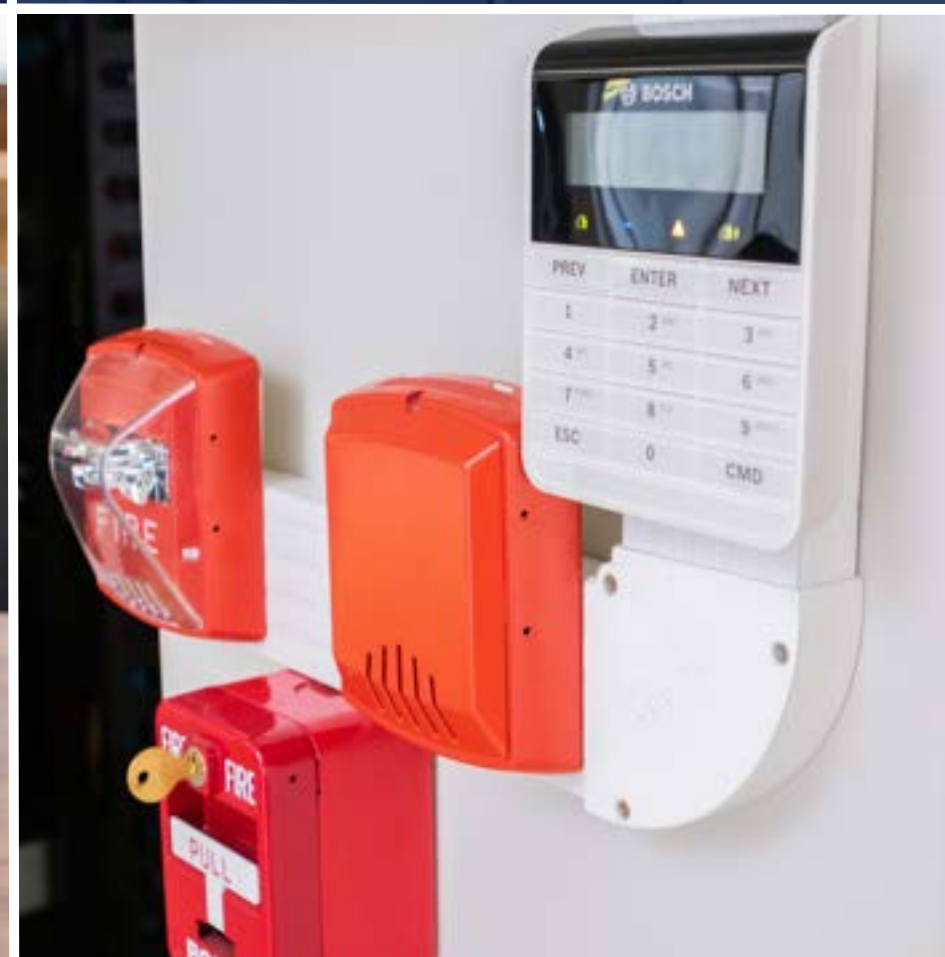
Prevenção de Incêndio
